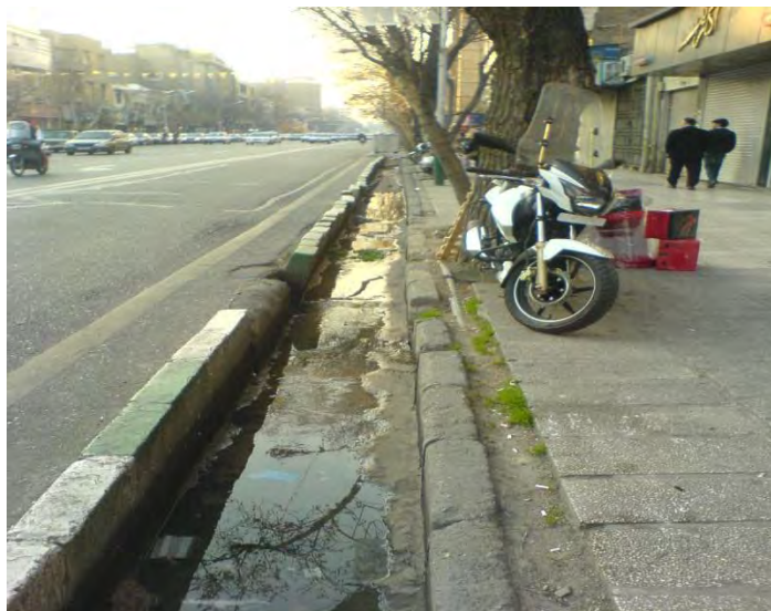
شکل 6: کمبود پل برای گذر از آبرو
